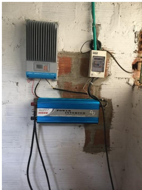
Fotografía 24. Inversor 3000w y Controlador MPPT. Fuente Propia.
