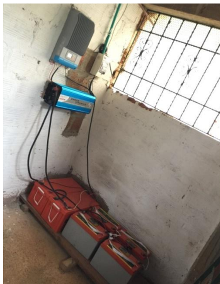
Fotografía 23. Banco de baterías, inversor y controlador. Fuente propia.
