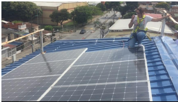
Fotografía 13. Paneles solares en el techo. Fuente propia
