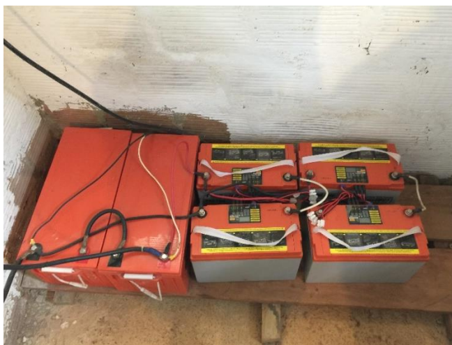
Fotografía 25. Banco de baterías. Fuente propia.
