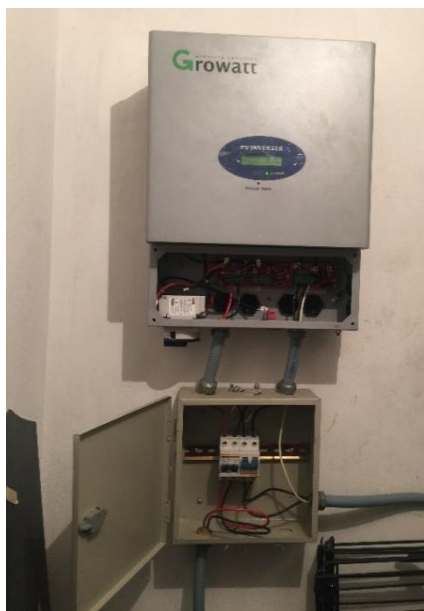
Fotografía 20. Inversor. Fuente Propia
