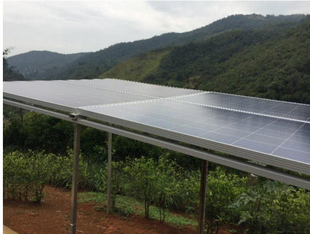
Fotografía 21. Estructura y paneles solares. Fuente propia
