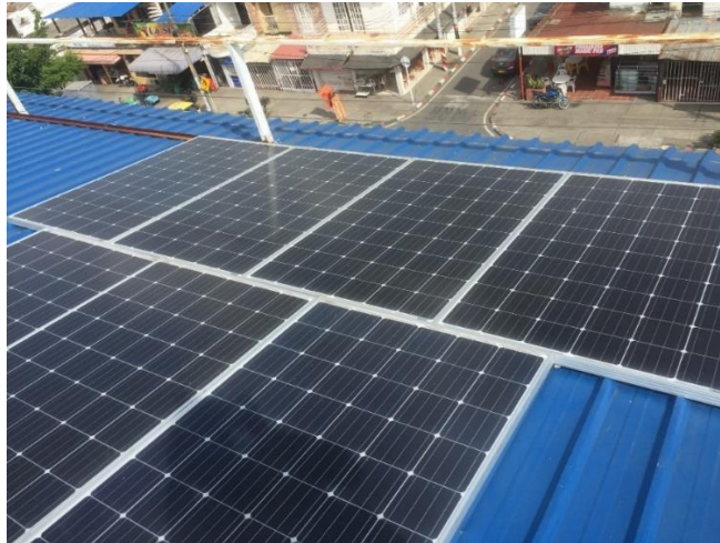
Fotografía 14. Paneles solares en Solomia. Fuente propia
