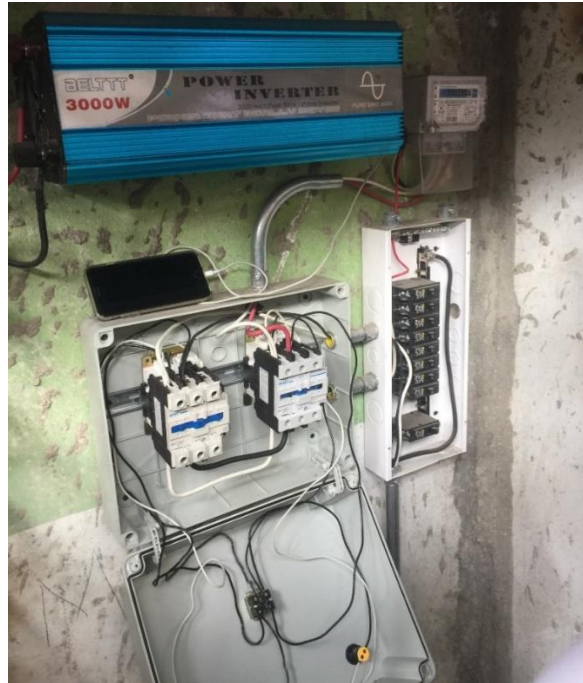
Fotografía 17. Inversor y sistema de transferencia manual. Fuente propia
