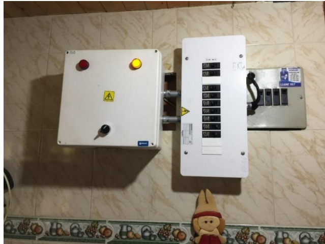
Fotografía 22. Transferencia manual y caja de brekers. Fuente propia
