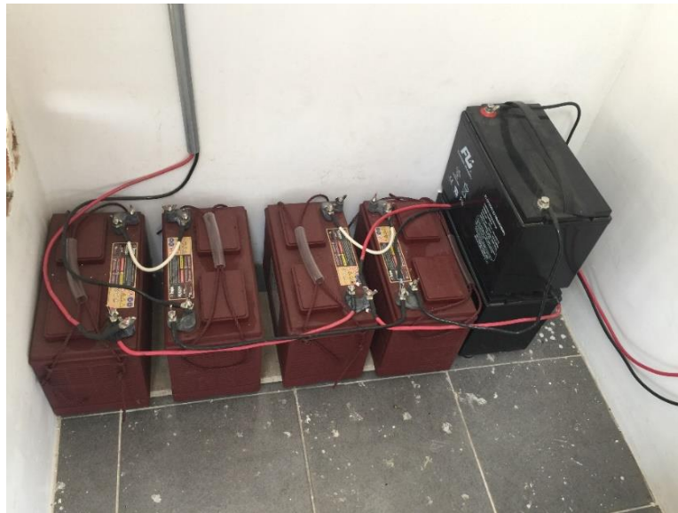
Fotografía 15. Banco de baterías. Fuente propia
