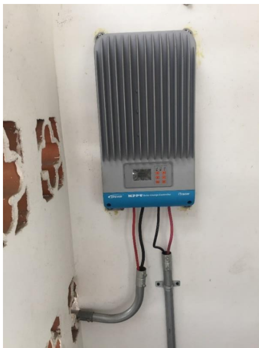
Fotografía 16. Controlados MPPT. Fuente propia
