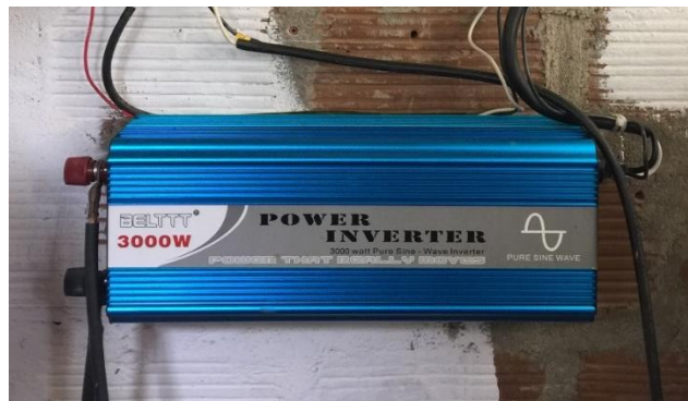
Fotografía 1. Inversor de 3000W. Fuente propia
