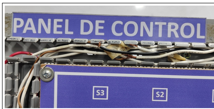
Figura 21: Cableado expuesto en la canaleta. Fuente: Propia.
