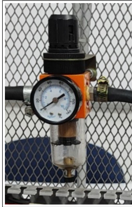
Figura 8: Filtro regulador de aire con trampilla de agua. Fuente: Propia.
