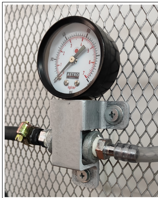
Figura 53: Nuevo soporte 3D montado en el manómetro. Fuente: Propia.
