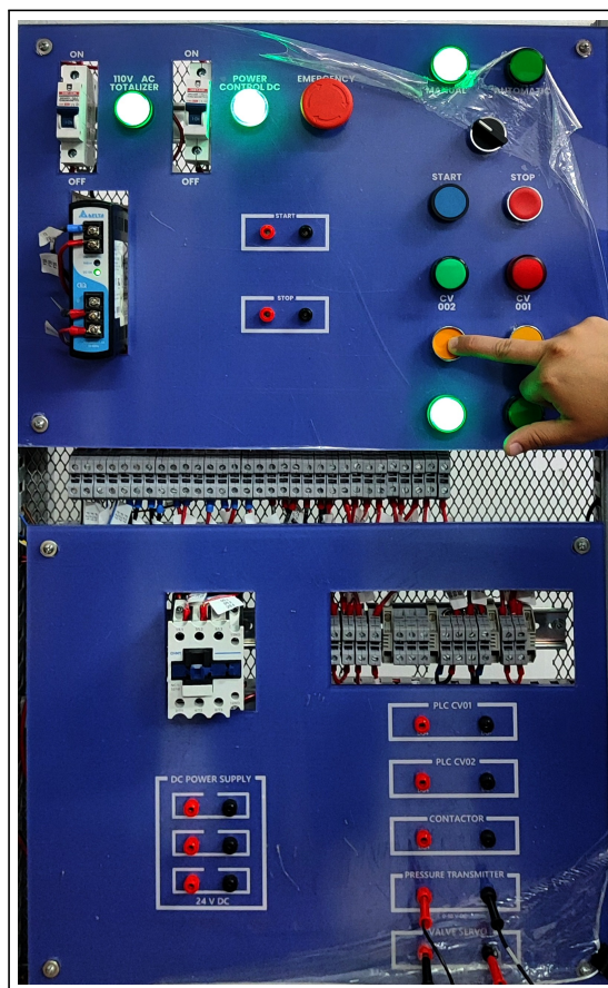
Figura 62: Activación de la electroválvula CV 002. Fuente: Propia.
