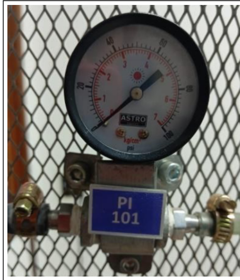
Figura 9: Manómetro. Fuente: Propia.
