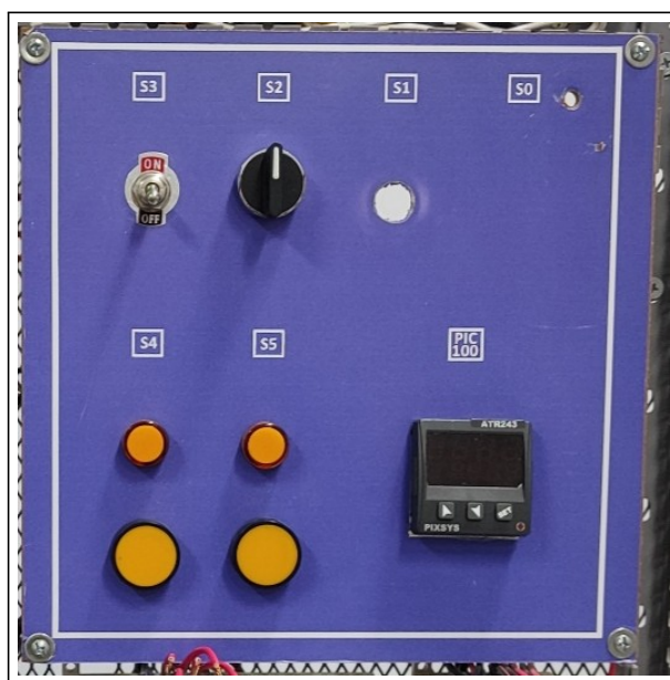
Figura 26: Tablero de mando superior. Fuente: Propia.
