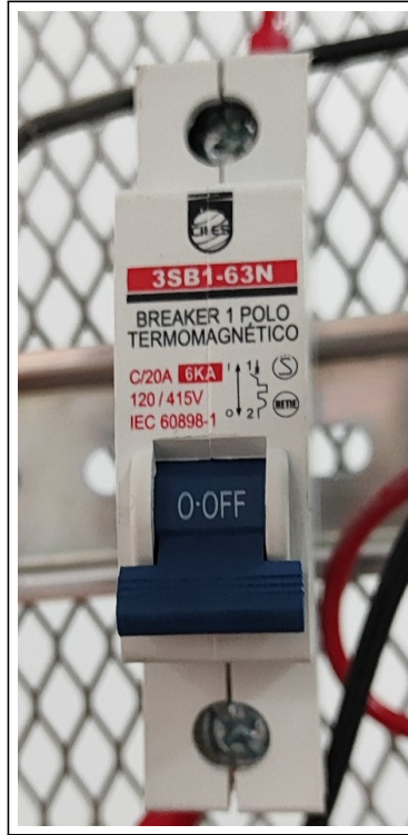
Figura 48: Minibreaker monofásico 20AMP. Fuente: Propia.
