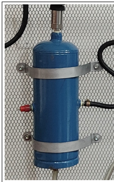
Figura 7: Tanque de compresión de aire. Fuente: Propia.
