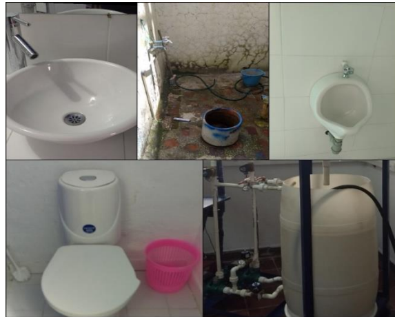
Figura 21: Hallazgos relacionados con el uso del recurso hídrico en la sede del laboratorio de ingenierías
