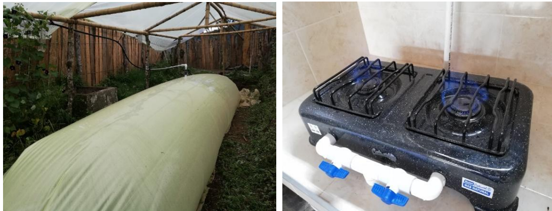
Figura 30. Biodigestor y estufa Instalado.
