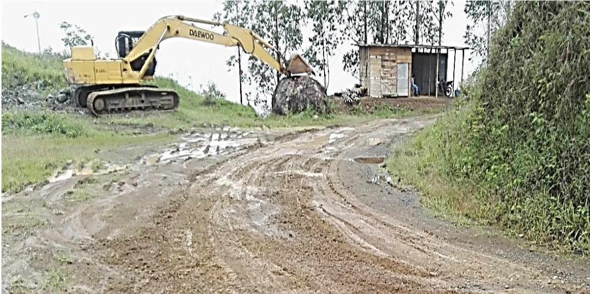
Figura 4. Encharcamiento de vía principal de acceso. Tomada por: Kevin Bastidas, 2018
