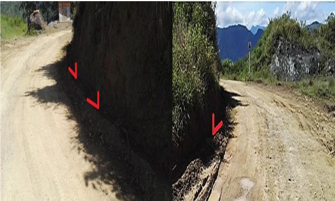
Fotografía N°6,7, Cunetas Perimetrales, Tomada en el año 2018 por Kevin Bastidas, En Vía de acceso a los Bancos de explotación, MANEJO DE AGUAS DE ESCORRENTÍA: EL AGUA LLUVIA QUE SE ACUMULA DENTRO DE LA CANTERA, ES CONDUCCIDA POR LOS CANALES A LO LARGO DE LA MINA
