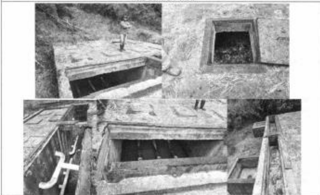
Tanque séptico y Tanque FAFA.
