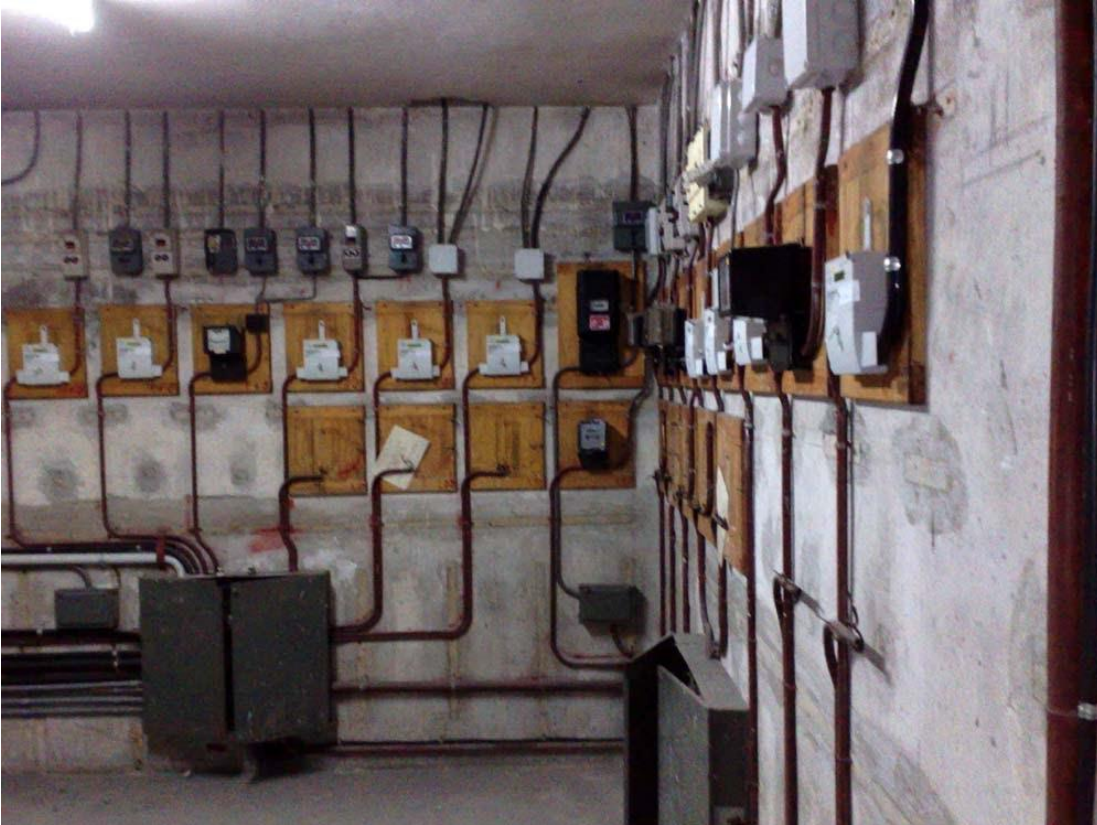
Figura 13. Conexiones eléctricas en buen estado y organizadas
