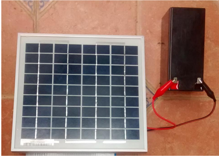
Fotografía 14: conexión entre panel solar y batería. Propia.
