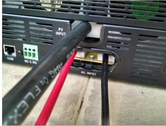
Fotografía 12: así queda la conexión al equipo multifuncional. Tomada de [37].
