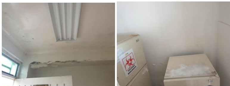
Figura 9: Estado área de almacenamiento
