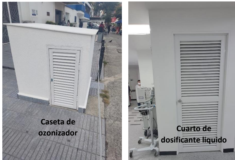
Figura 4. Casetas de almacenamiento de los sistemas de oxidación avanzada. Fuente propia.
