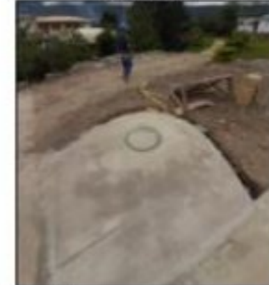
Ilustración 13. Cámara de salida de aguas residuales
