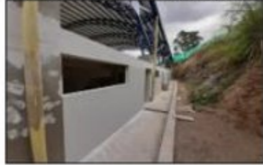
Ilustración 10. Baños de construcción
