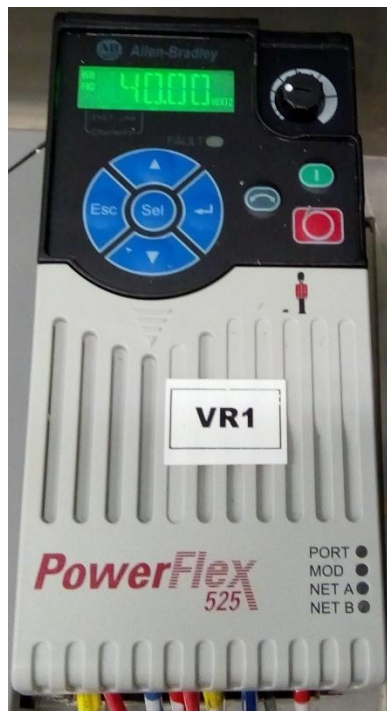
Figura 4-6: Funcionamiento de variador a 40 hz. Fuente: autor.
