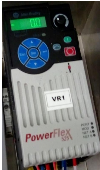
Figura 4-9: Frecuencia del variador. Fuente: Autor.
