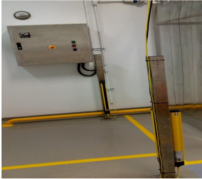
Figura 3-33: Base central, tablero de control y base lateral. Fuente: autor.
