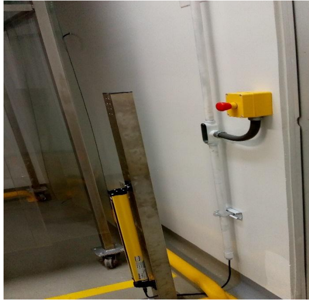
Figura 3-31: Base en acero inoxidable, cortina y paro de emergencia. Fuente: autor.
