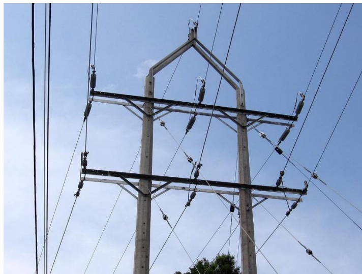
Figura 7: Crucetas metálicas para armado de postes. Fuente [17].
