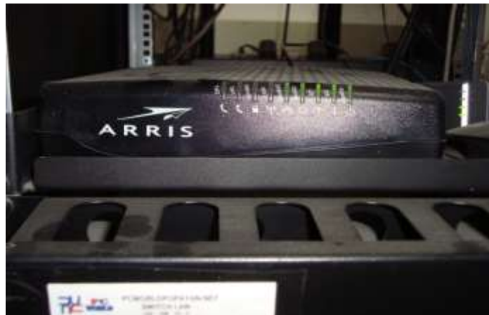
Fotografía 20. Router de la empresa Claro Colombia.
