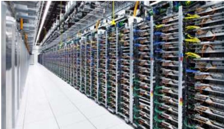
Fotografía 1. Distribución de cableado en un centro de datos
