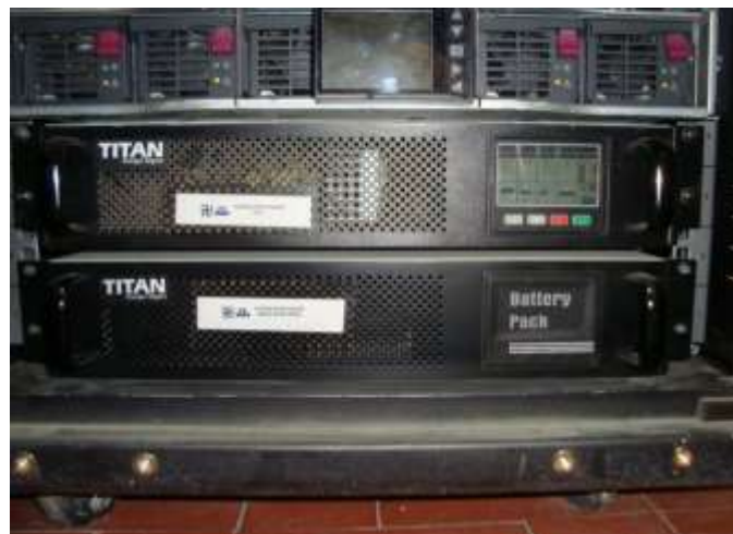
Fotografía 36. UPS y Batería.
