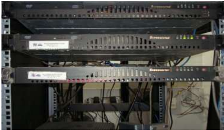
Fotografía 19. Servidores de monitoreo y VoIP.
