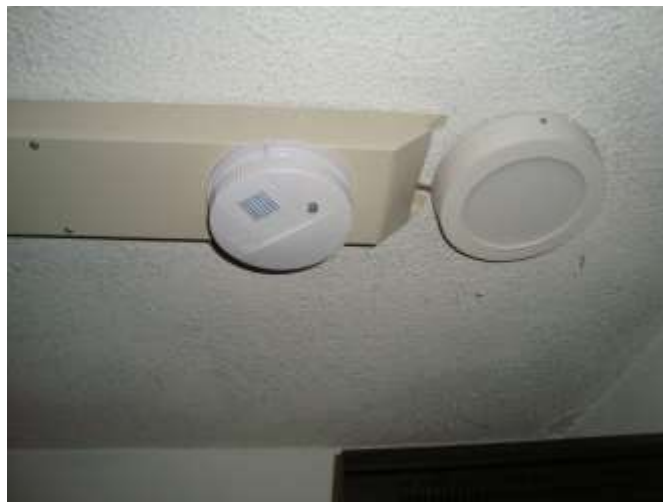
Fotografía 34. Detector de humo pasillo frio.
