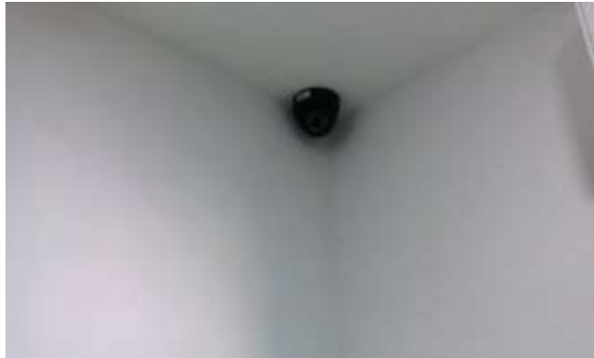
Fotografía 27. Cámara en el interior del Centro de Datos.
