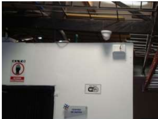
Fotografía 28. Cámara fija en la entrada del centro de datos.
