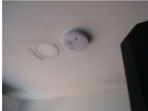
Fotografía 33. Detector de humo pasillo frio.
