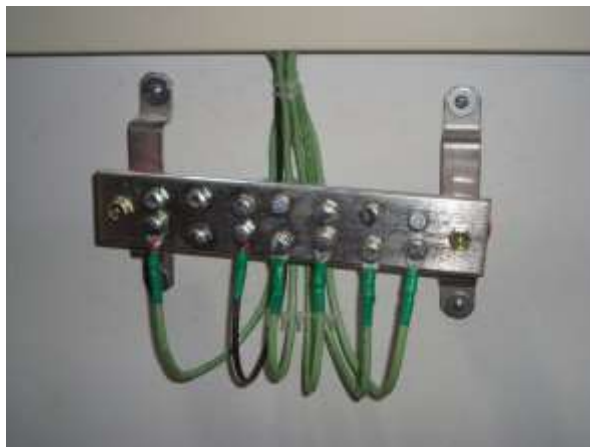
Fotografía 43. Barra de tierra para telecomunicaciones.
