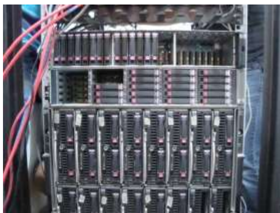
Fotografía 46. Instalación de blade en el centro de datos.
