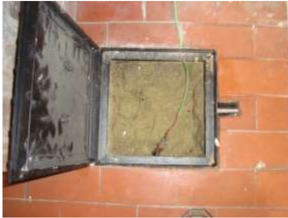
Fotografía 42. Cable fundido con barra de cobre para sistema de puesta a tierra.
