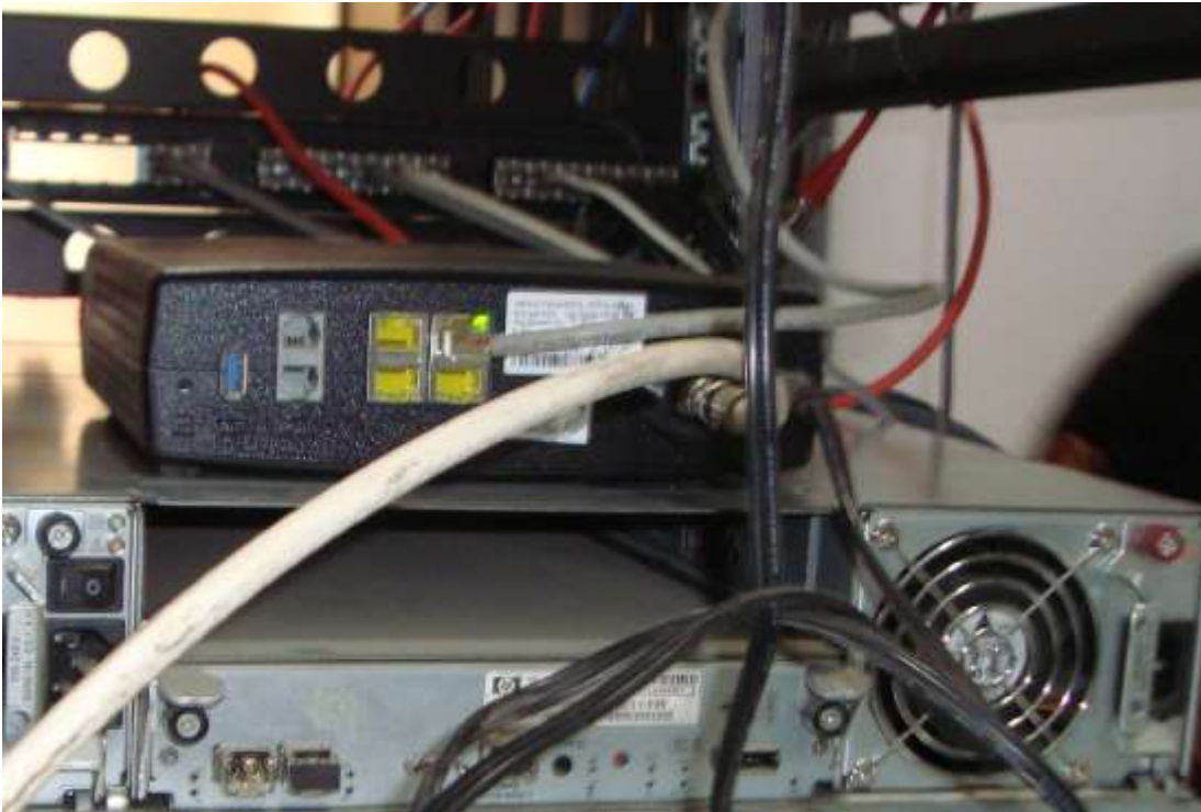
Fotografía 45. Instalación router de Claro Colombia.
