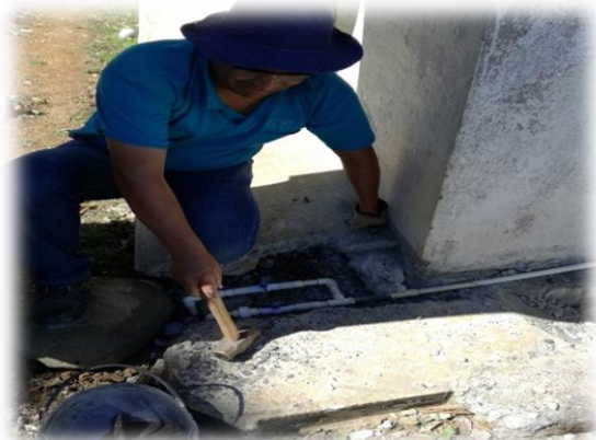
Figura 19 Identificación de fugas.
