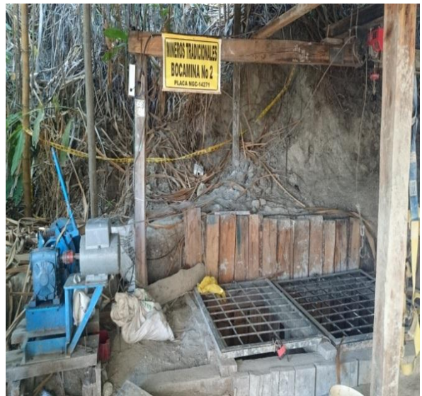
Fotografía No. 4 Lugar: Vereda La Laja Sector La Marta Municipio de Rosas Cauca. Observación (Clavada para extraer material).
