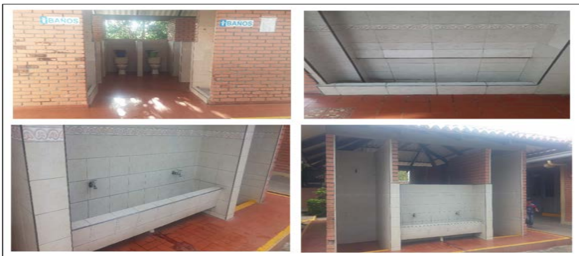
Figura N° 19. Estructuras hidrosanitarias en la Unidad 2 ICBF sede Regional cauca (Hogar Jardín Infantil).
