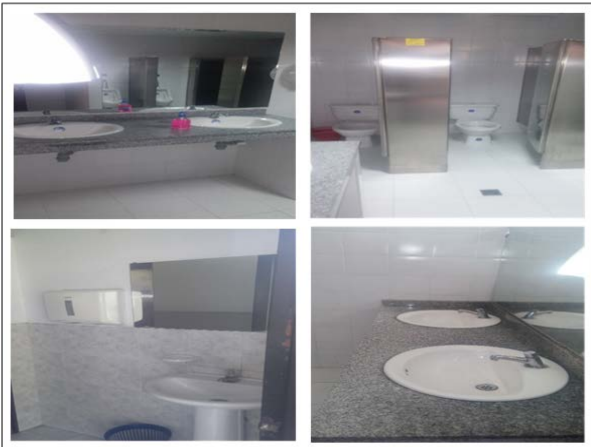
Figura N° 9. Estructuras hidrosanitarias en la Unidad 1 del ICBF sede Regional cauca.
