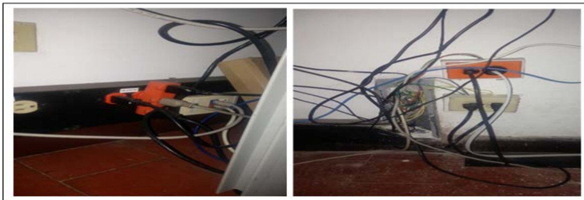
Figura N° 14. Conexiones inadecuadas Unidad 1 del ICBF sede Regional cauca.
