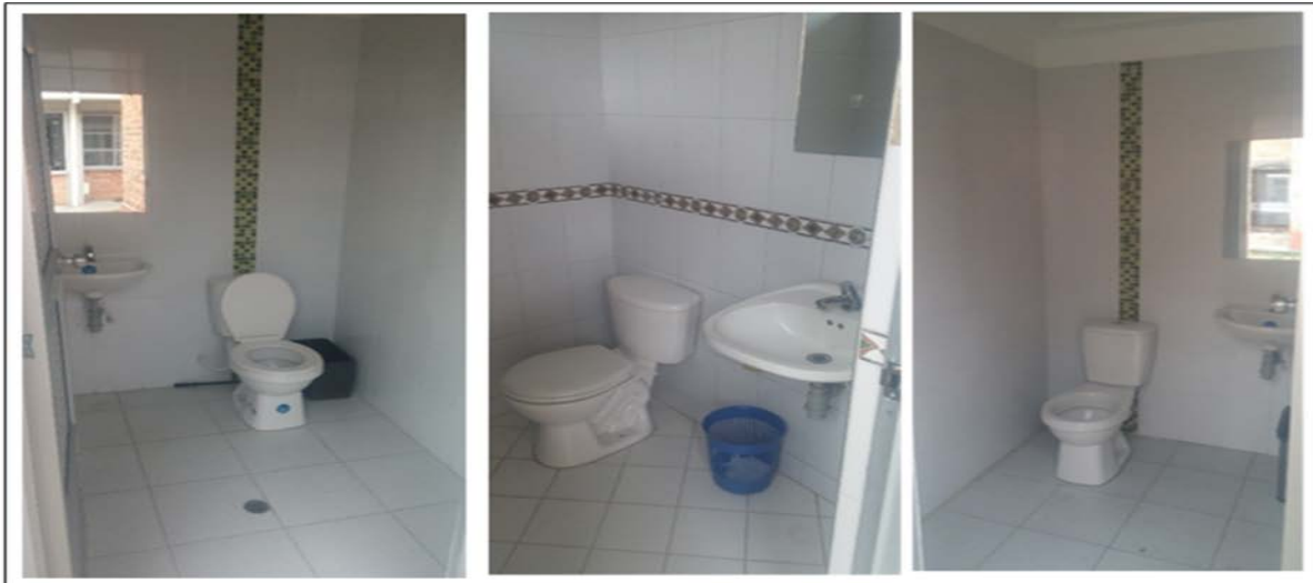
Figura N° 25. Estructuras hidrosanitarias en la Unidad 3 ICBF sede Regional.
