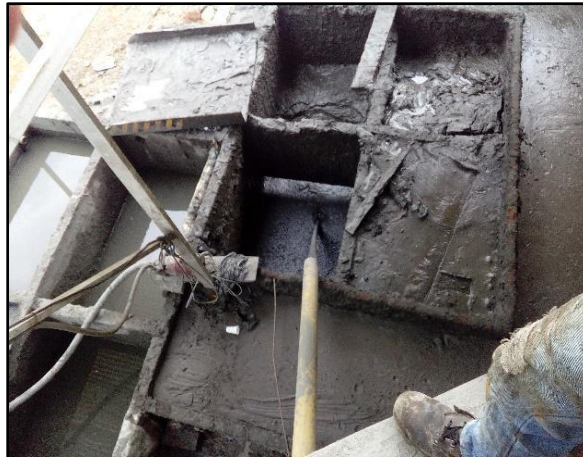
Figura 23. Tanques de sedimentación de lodos
