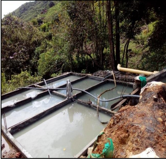
Figura 6. Tanques de sedimentación
