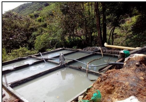
Figura 18. Colectores de agua y sedimento
