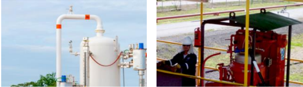
Ilustración C. Calderas unidad Slop Oil
