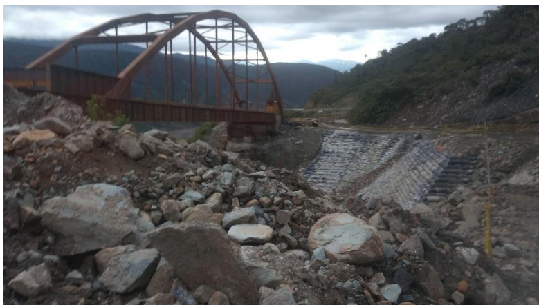
Imagen 21 Colapso del puente sobre la quebrada Córdoba en la carretera Popayán-Totoró-Inzá-la Plata
