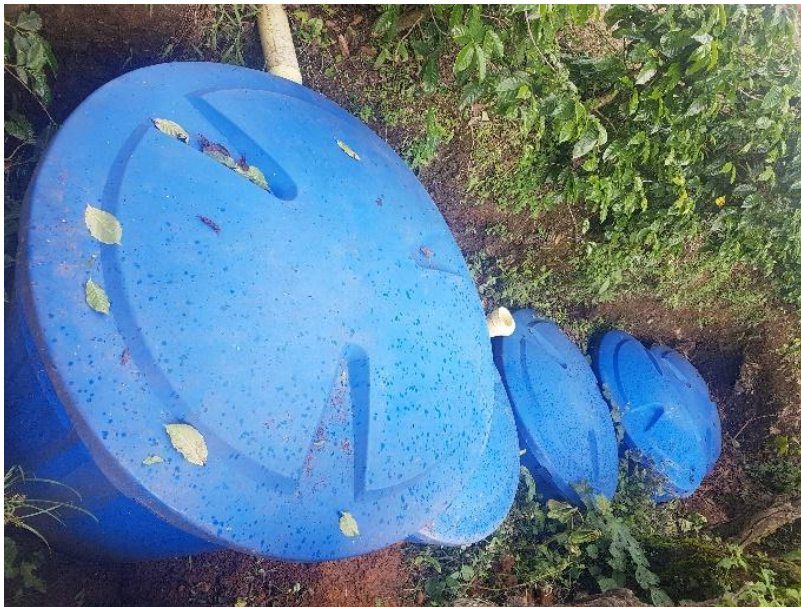
Figura 24. Vista del tratamiento existente para tratar el agua de salida al sistema de las aguas mieles.
