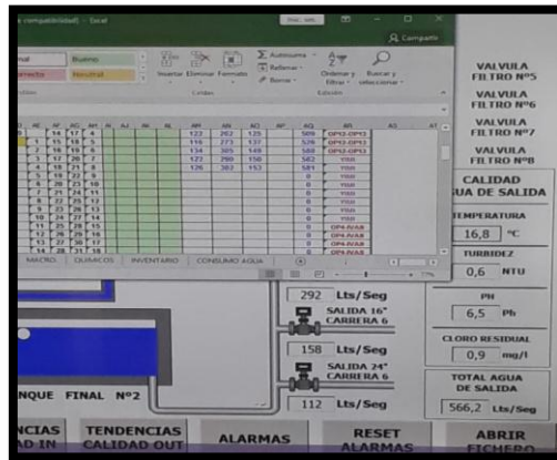
Figura 9. Medición con el macromedidor de caudal (Q)
