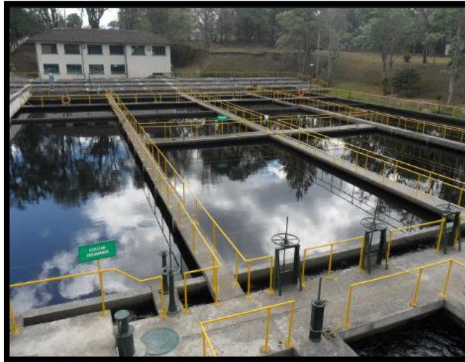
Figura 3. Planta de tratamiento de agua potable El Tablazo
