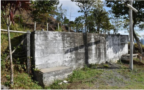
Tanque de distribución
