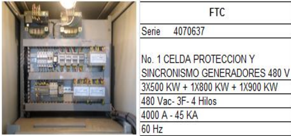
Figura 10. Celda de protección y sincronismo
