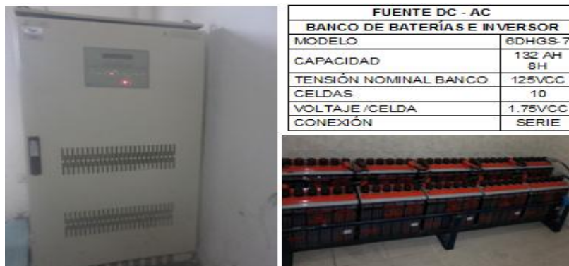
Figura 15. Fuente de alimentación de emergencia
