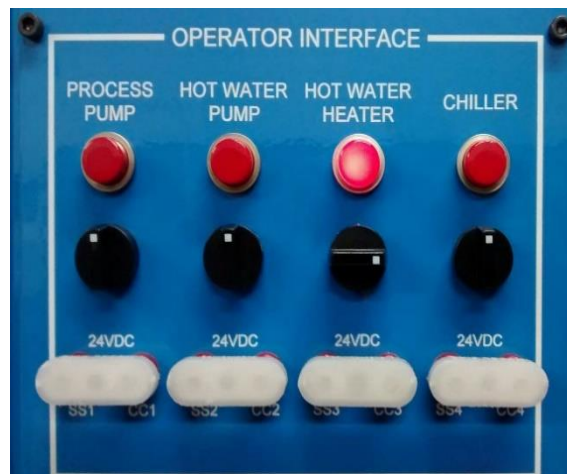
Fotografía 5: Calentador del tanque de servicio en estado encendido
