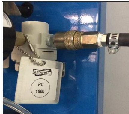
Fotografía 2: Conexión del suministro de aire.
