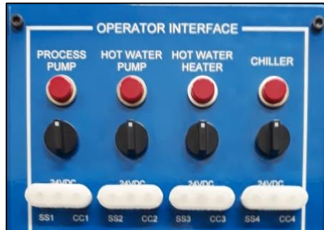
Fotografía 1: Interfaz de operador
