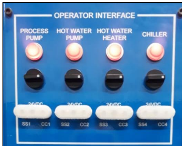
Fotografía 1: Interfaz de operador.
