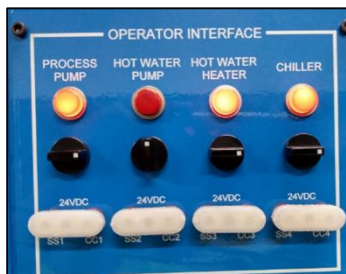
Fotografía 8: Interfaz de operador
