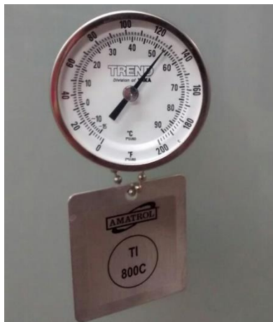
Fotografía 7: Indicador de temperatura del tanque de servicio
