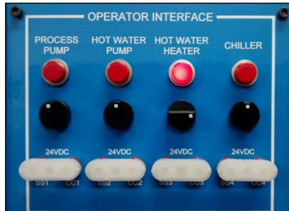
Fotografía 5: Calentador del tanque de servicio en estado encendido
