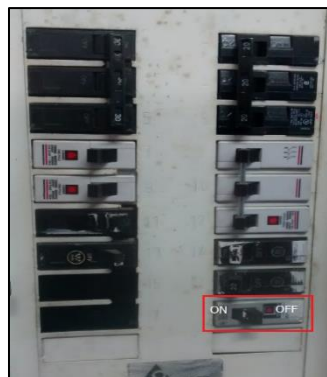
Fotografía 3: Switch del compresor.
