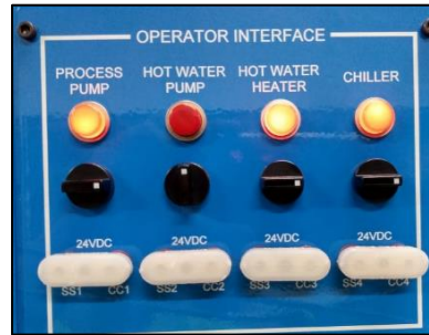
Fotografía 8: Interfaz de operador
