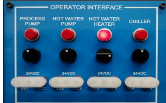
Fotografía 5: Calentador del tanque de servicio en estado encendido
