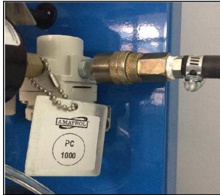
Fotografía 2: Conexión del suministro de aire.
