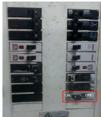
Fotografía 3: Switch del compresor.
