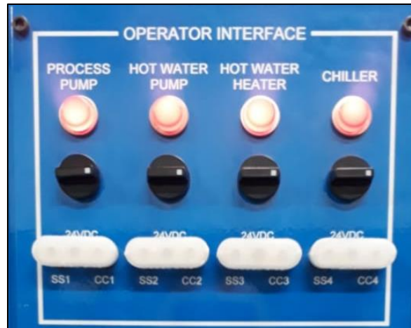
Fotografía 9: Interfaz de operador
