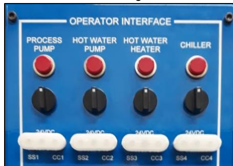
Fotografía 1: Interfaz de operador
