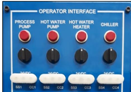
Fotografía 1: Interfaz de operador
