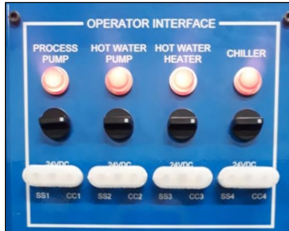
Fotografía 9: Interfaz de operador.
