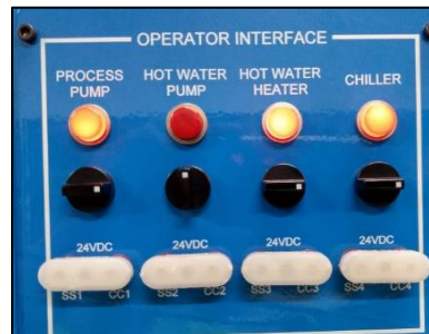
Fotografía 8: Interfaz de operador
