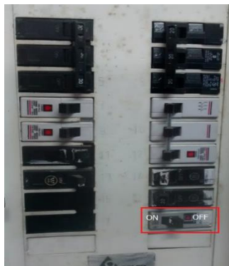
Fotografía 3: Switch del compresor.
