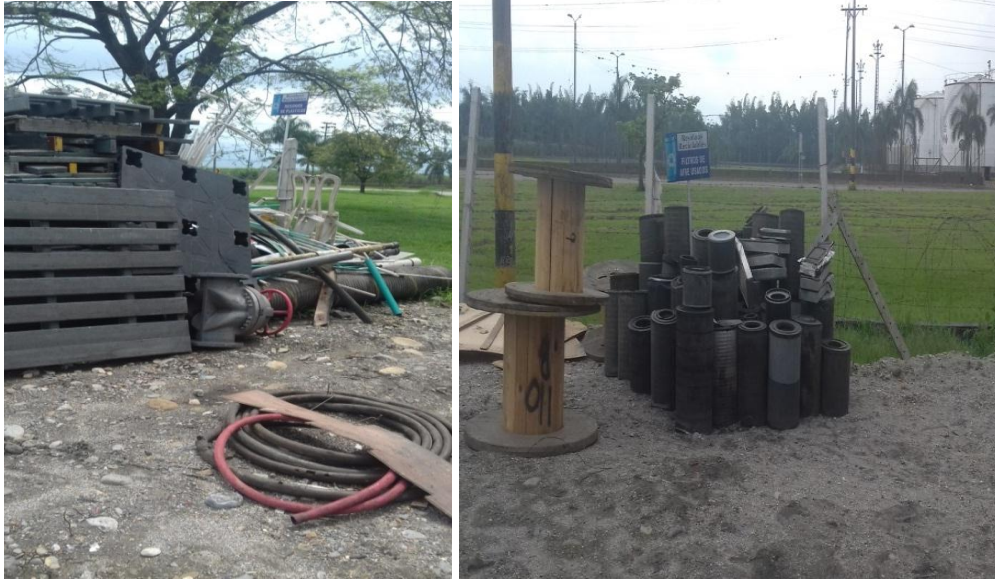
Imagen 10. Inspección ambiental-Acopio inadecuado de Residuos sólidos.
