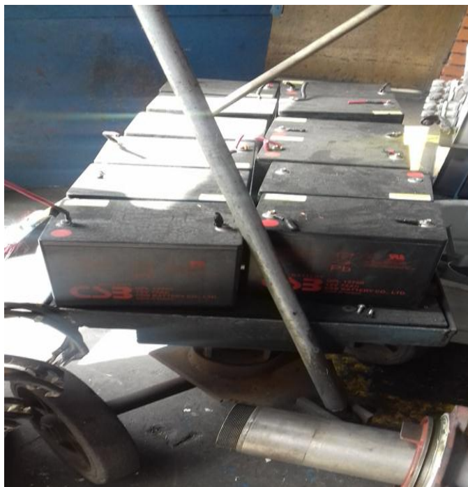
Imagen 2. Inspección ambiental- almacenamiento Incorrecto de Residuos peligrosos.
