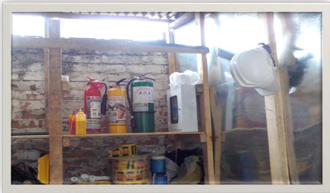
Fotografía 22. Almacenamiento de Extintores.
