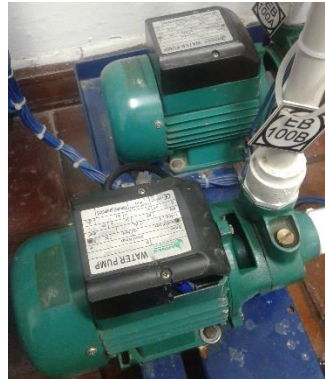
Figura 28 Bombas centrífugas BARNES-QB60. Fuente: Autor
