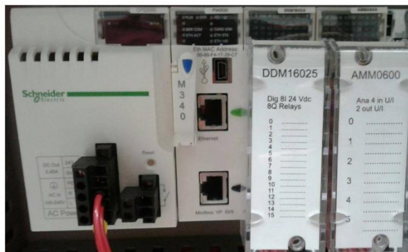
Figura 10 Controlador PLC Modicon M340 Schneider Electric. Fuente: Autor
