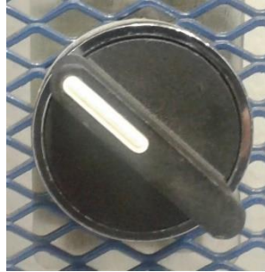
Figura 39 Perilla de parada de emergencia. Fuente: Autor
