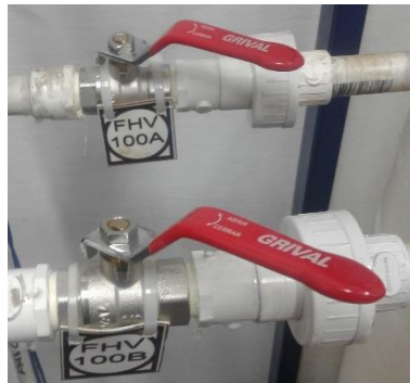
Figura 30 Válvulas manuales BYPASS. Fuente: Autor
