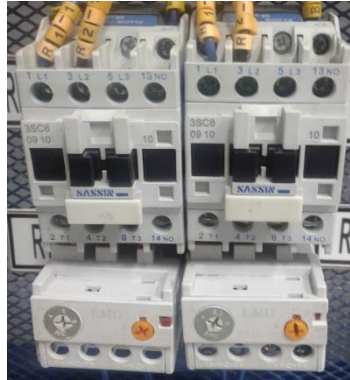
Figura 41 Contactores SASSIN 3SC8. Fuente: Autor
