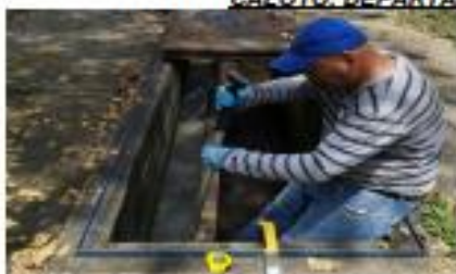
Foto 1. Lugar: Casco urbano municipio de Caloto. Fecha: 2 de marzo de 2020. Observación: Vertedero tipo lateral con tapas en lámina aljofir y bypass.
