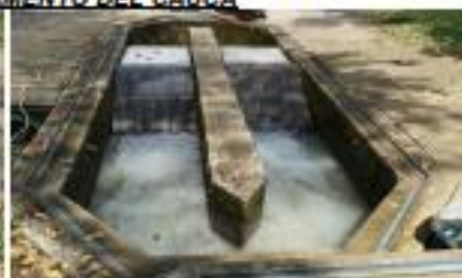
Foto 2. Lugar: Casco urbano municipio de Caloto. Fecha: 2 de marzo de 2020. Observación: Cámara de cribado obble con rejilla metálica perpendicular al flujo.
