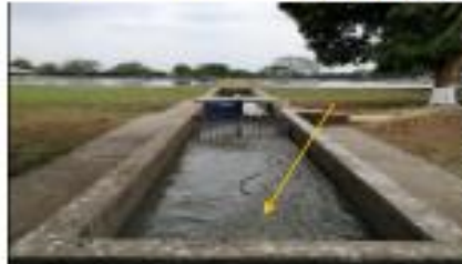
Foto 1. Lugar: Casco urbano municipio de Corinto. Fecha: 4 de marzo de 2020. Observación: Cámara de cribado doble con desarenador (punto de toma de muestra).
