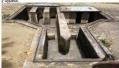
Foto 3. Lugar: Casco urbano municipio de Caloto. Fecha: 2 de marzo de 2020. Observación: Cámara de distribución de caudales construida para seis (6) líneas de tratamiento.
