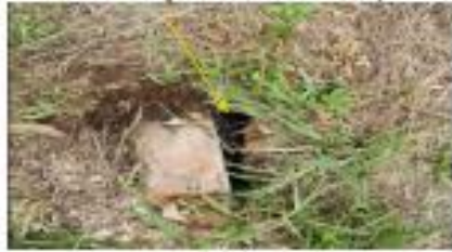
Foto 3. Lugar: Casco urbano municipio de Corinto. Fecha: 4 de marzo de 2020. Observación: Tubería de salida de cámara de distribución de caudales en mal estado.
