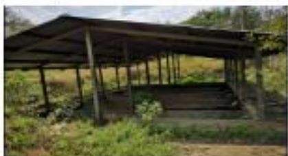
Foto 5. Lugar: Casco urbano municipio de Caloto. Fecha: 2 de marzo de 2020. Observación: Lechos de secado de lodos con falta de mantenimiento.
