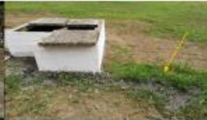
Foto 2. Lugar: Casco urbano municipio de Corinto. Fecha: 4 de marzo de 2020. Observación: Cámara de distribución de caudales, se evidencia filtración.
