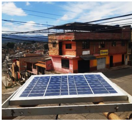
Figura 2.1.2 Panel solar del sistema energético
