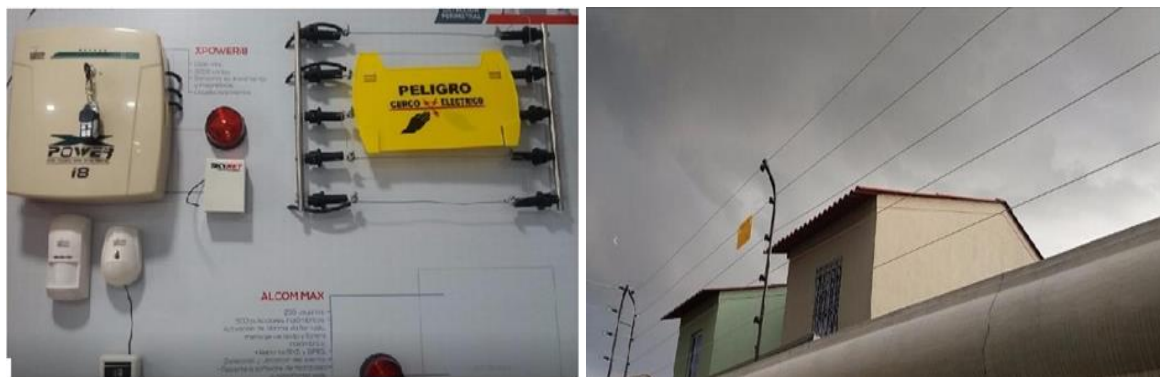
Fotografía 14. Cerca Eléctrica. Fuente: (SISEGOM, 2018).
