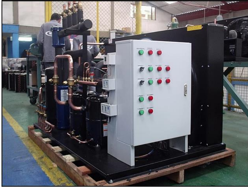
Fotografía 16. Unidad de motores de 15hp, compresores, secadores y Filtros; para cámara de conservación. Fuente: (RefrigeracionCastell, 2018).
