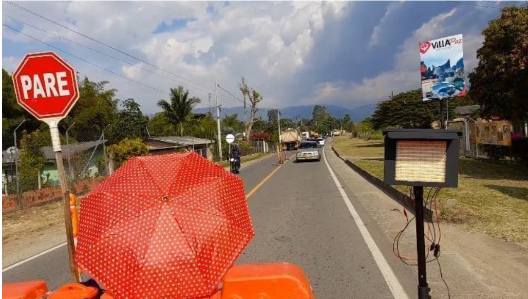
Figura 47. Señal de siga, costado 2. Kilómetro 12. (imagen tomada desde el costado 1)
