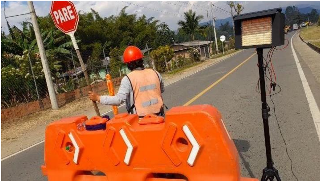
Figura 45. Señal de pare, costado 1. Kilómetro 12.
