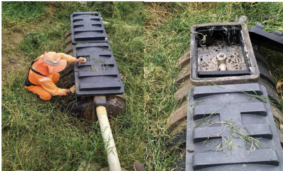
Figura 2. Sistema de tratamiento de lixiviado planta de compostaje
